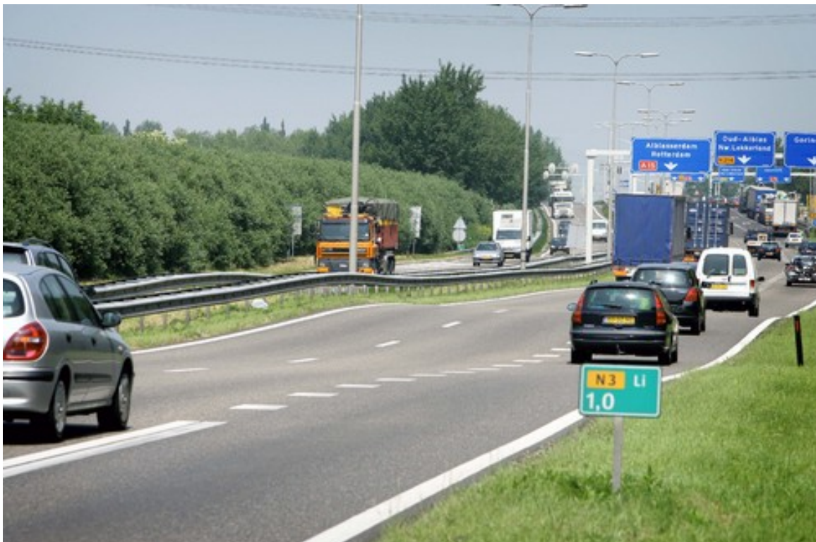
Figuur 1: Door ongelijkmatige zettingen komen comfort eisen in het geding en het leidt tot imagoschade.
