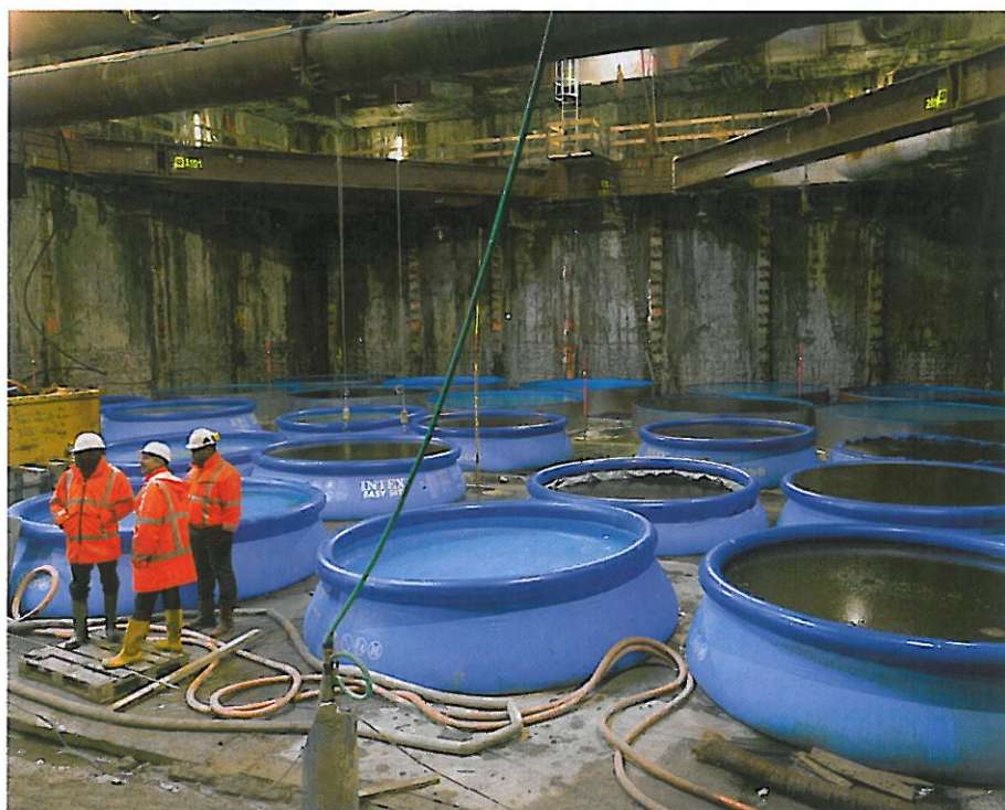
Station Rokin van de Amsterdamse Noord/Zuidlijn, december 2010 op NAP -26,5 meter; te zien zijn zwembadjes als extra ballast en monitoringinstrumenten (zoals peilbuizen en 'hoogtemeters').
