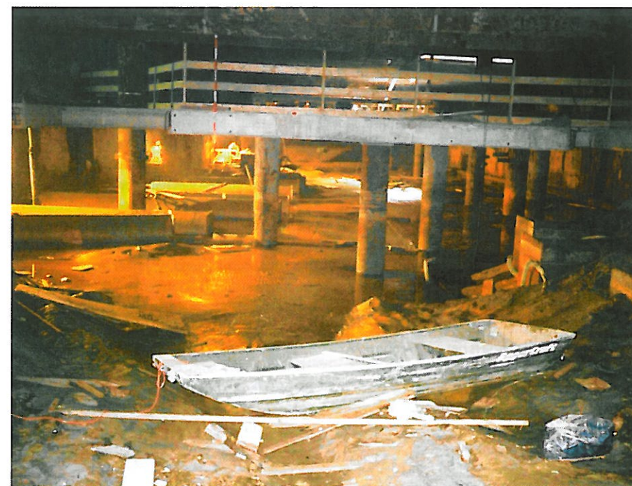
De Haagse tramtunnel in 1998, na het ontstaan van de lekkage in de groutboog.
