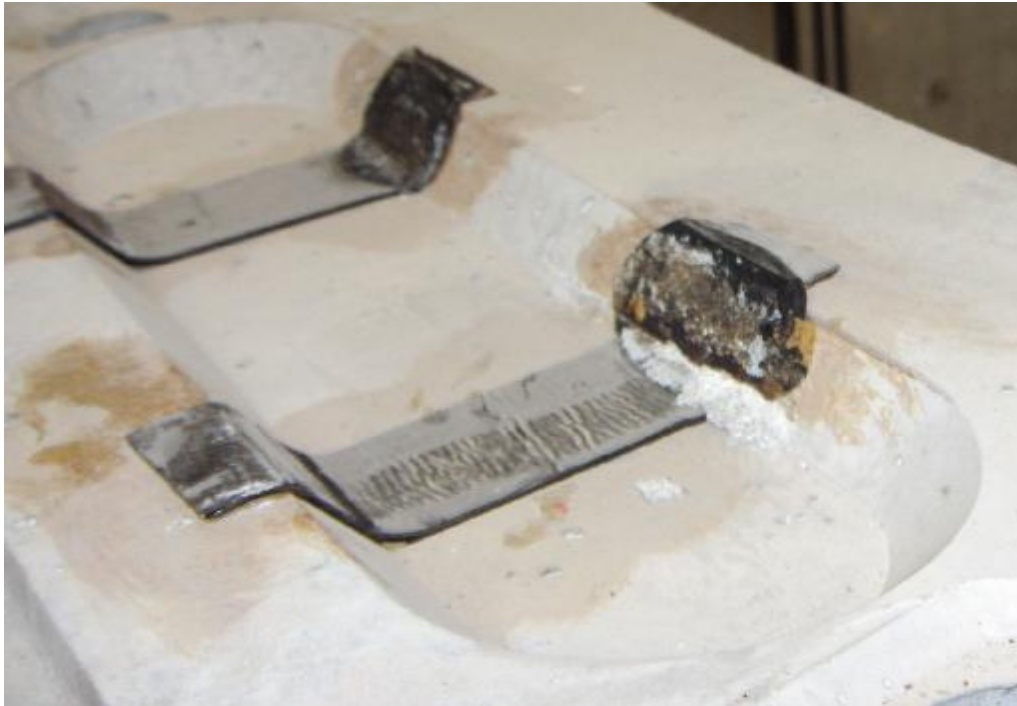
Restanten van beschadigde schuifnokken na aanliggen van nokken in inkassing
